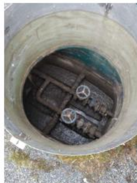
Chambre de vannes
