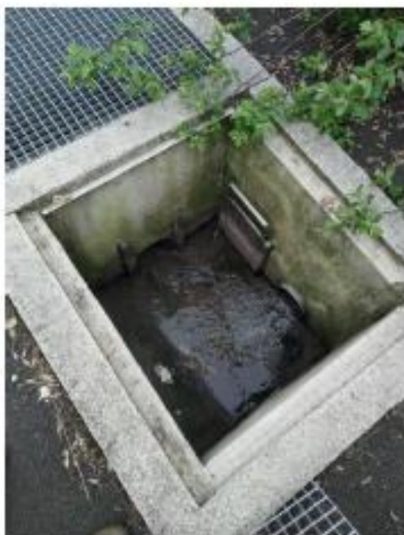
Entrées dessableur (2 arrivées car 2 antennes) et bypass pour maintenance de l'ouvrage
